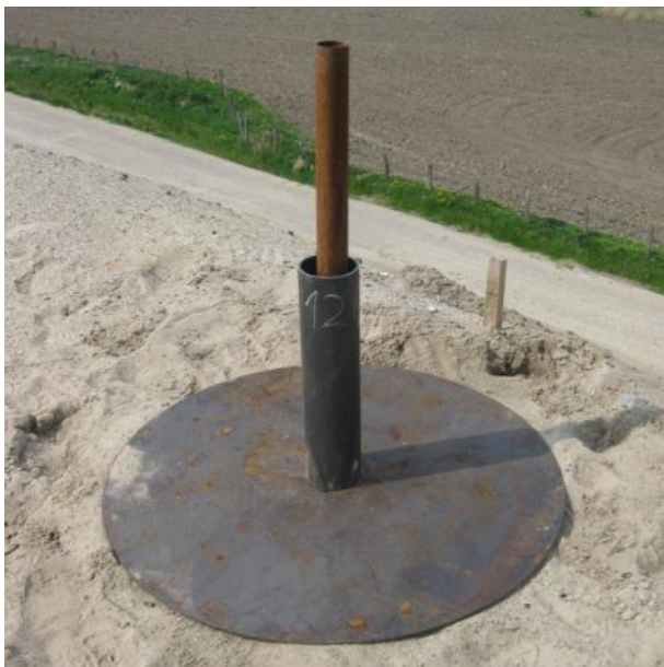
Bild 14: Pegelreflektor installiert auf Überschüttdamm im Testgebiet 3. Foto © BASSt 2014.
