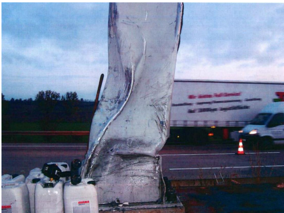
Abbildung 17 - Detailansicht der plastischen Verformung der Stütze
