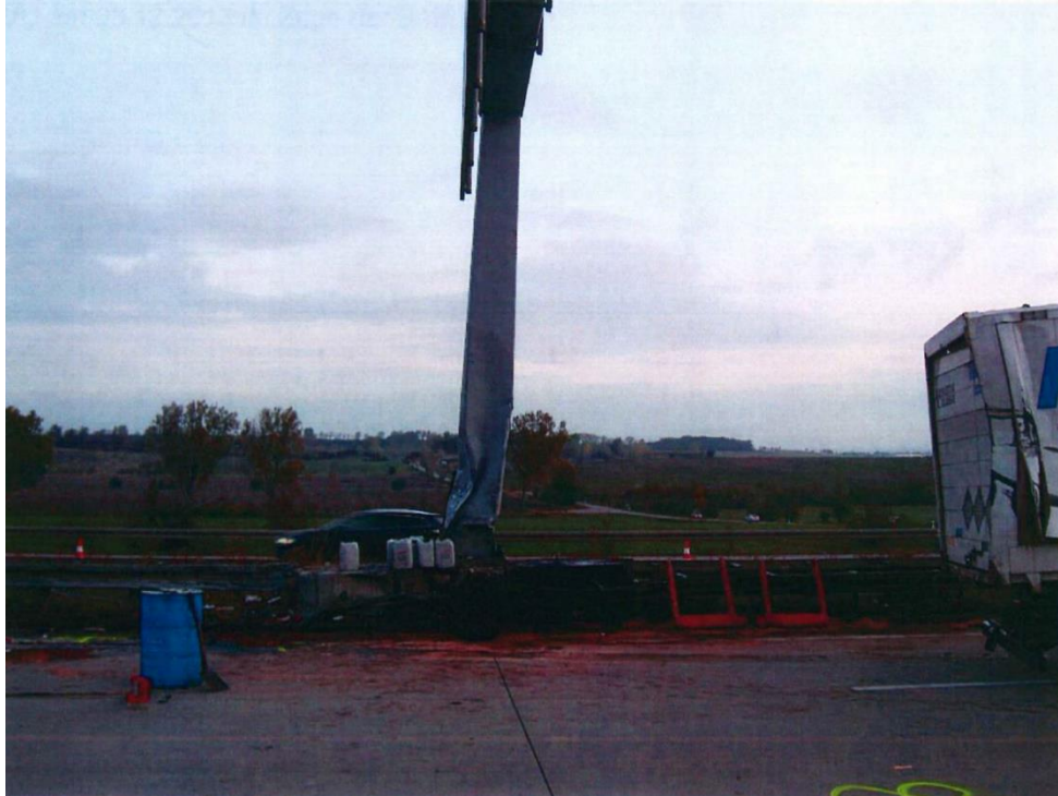
Abbildung 16 - Blick auf die plastisch verformte Stütze der Verkehrszeichenbrücke
