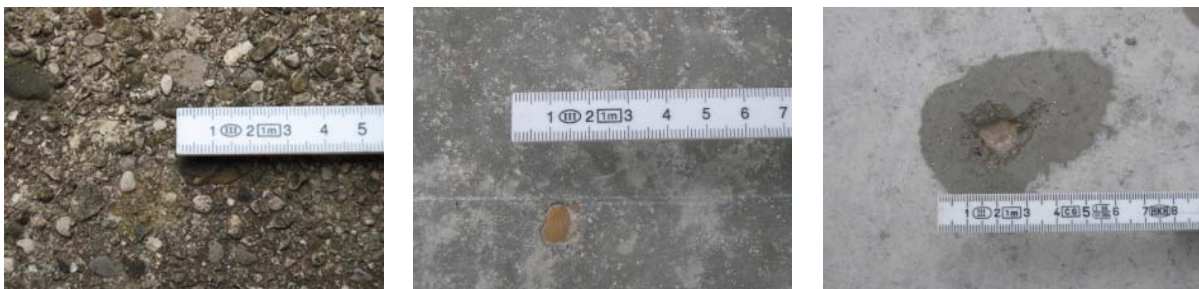
Abbildung 3: Beispiele für Frost-Tausalz-Schäden (Schädigung der Oberfläche; links: Absanden der Oberfläche, Mitte: Ablösen der Zementleimschicht über einer Gesteinskörnung; rechts: Popout verursacht durch die Auflösung einer Gesteinskörnung)
