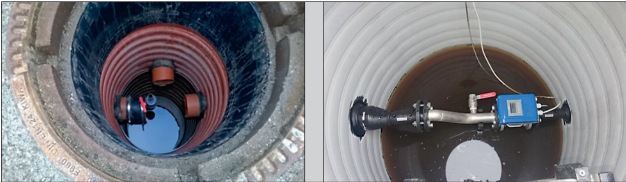
Bild 2-9: Eintritt von Grundwasser in den Rezirkulationsschacht (links) und Messschacht (rechts)
