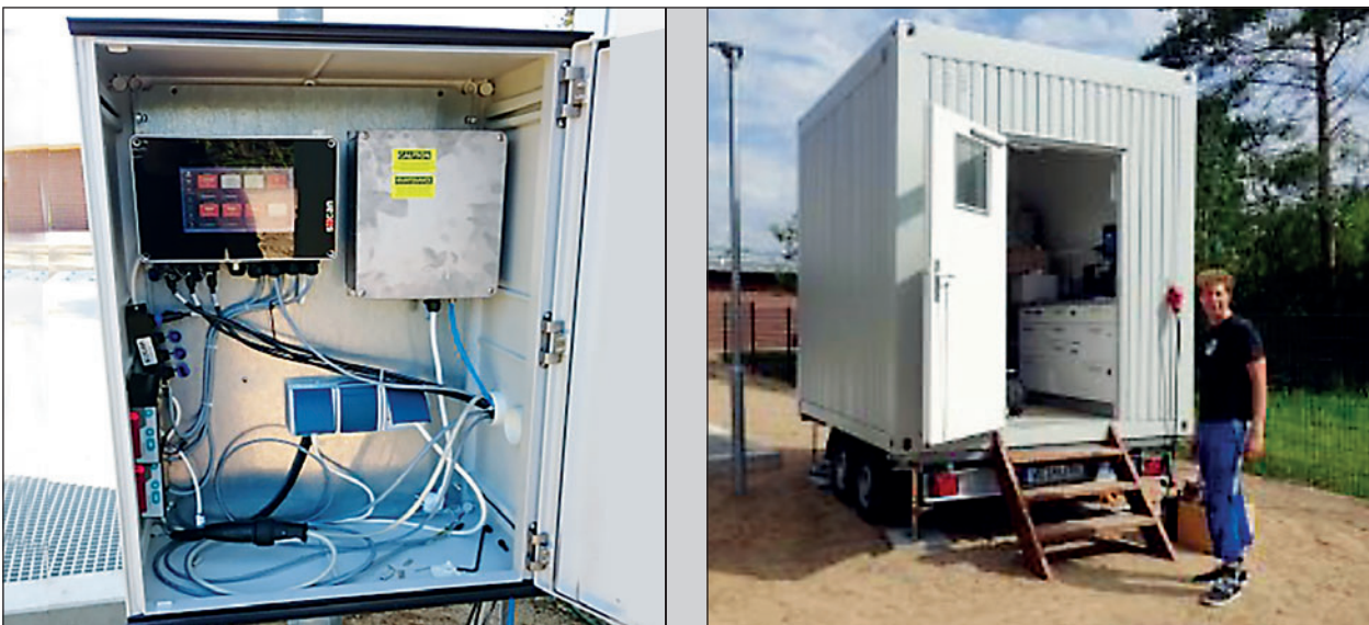
Bild 2-10: Datenlogger (links) und Feldlaborcontainer (rechts) auf der Pilotanlage
