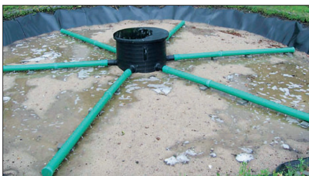
Bild 2-8: Unzureichende Abwasserverteilung auf den Bodenfiltern
