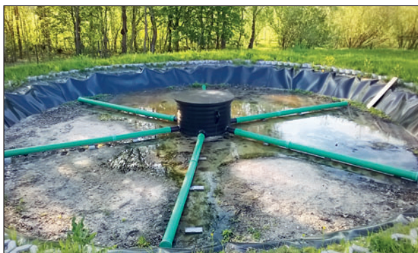
Bild 3-25: Kolmationserscheinungen durch Überlastung des Bodenfilters infolge fehlerhafter Verteilung (Schieber in Verteilerschacht defekt)
