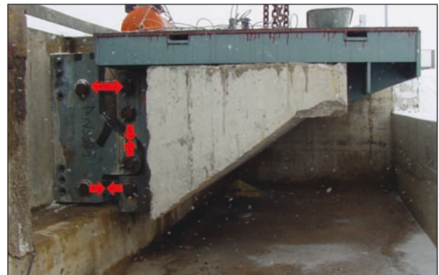
Bild 21: Messgrube mit Tragkonsolelement aus Stahlbeton, Stahlkonstruktion für Höhenausgleich und Lastverteilung und Aufhängung mit Augenstäben für Normalkraftmessung (TÜV Automotive GmbH)
