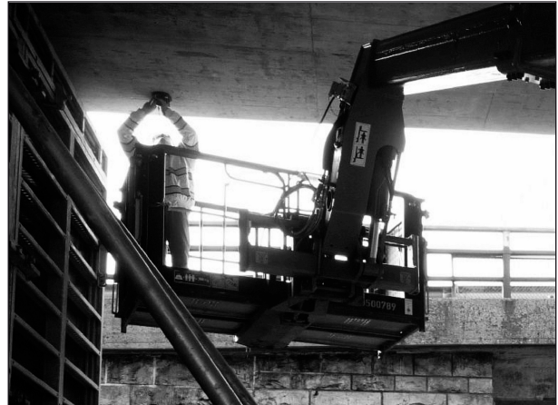
Bild 39: Messung an den Detektoren 7530671.1-3B-04-C und 7530671.1-3C-02-H von einer Arbeitsbühne
