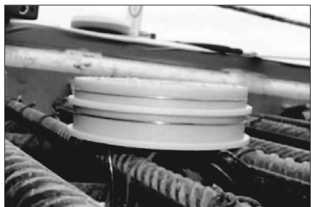
Bild 24: Bewehrungsstahl mit Korrosionsdetektor
