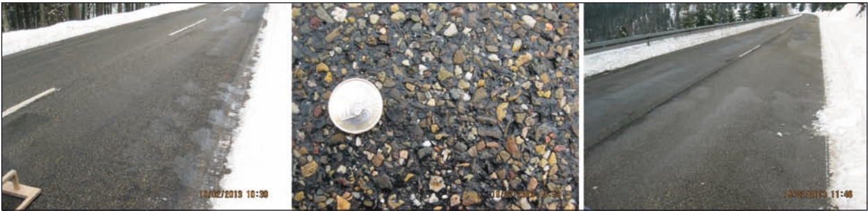
Bild 91: Fahrbahnzustände des 1. Messfeldes am 19.02.2013 auf der Messstrecke L66b_c (links und Mitte), sowie L66b_b (rechts), jeweils Fahrtrichtung B, KW 08-2013, Gernsbach
