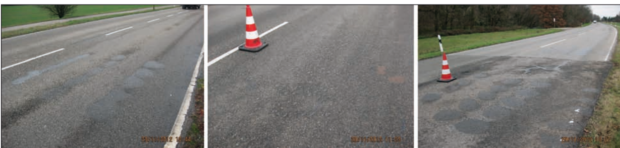
Bild 44: Fahrbahnzustand zu Beginn der Messreihe (links), Solespuren auf der Fahrbahn (Mitte), Wechsel der MTD in FRA (rechts), KW 48-2012, Grabener Straße, Karlsruhe
