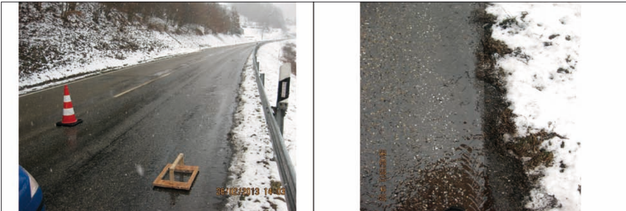
Bild 96: Nasser Fahrbahnzustand in Fahrtrichtung A, L66b_a, Gernsbach
