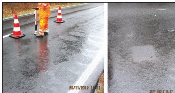
Bild 34: Nasser Fahrbahnzustand der L 604 am 26.11.2013, KW 48-2012, Karlsruhe
