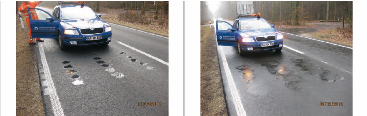
Bild 25: Fahrbahnzustand auf der L 604 am 01.03.2013 (links) und 02.03.2013 (rechts), KW 09-2013, Karlsruhe
