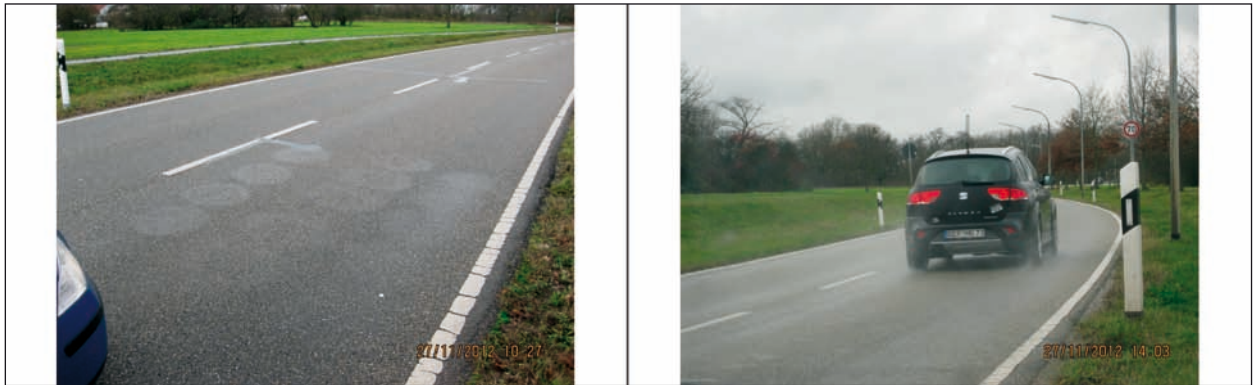
Bild 39: Feuchter (links) bzw. nasser (rechts) Fahrbahnzustand der Querspange am 27.11.2013, KW 48-2012, Karlsruhe
