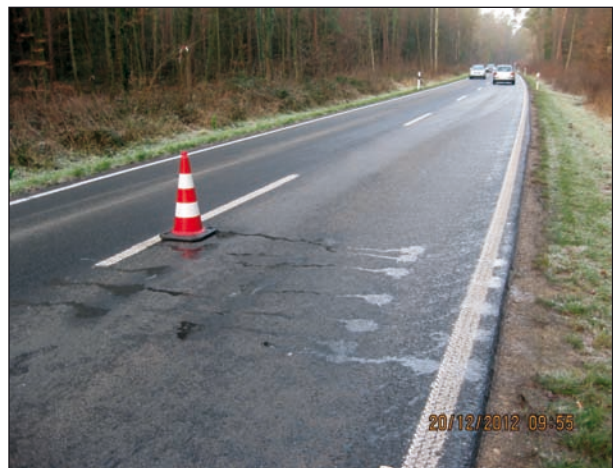
Bild 51: Fahrbahnzustand auf der L 604 in Fahrtrichtung A, KW 51-2012, Karlsruhe
