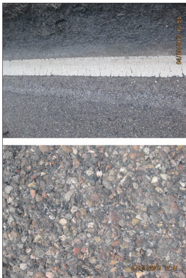
Bild 113: Salzfilm auf der Fahrbahn
