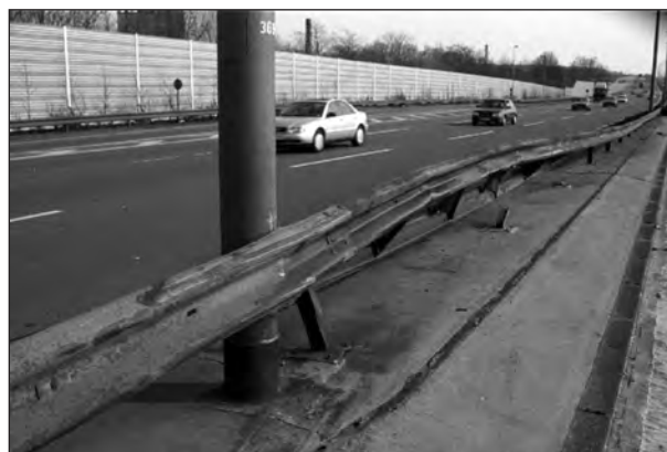
Bild 14: Durch den Anprall des Mercedes beschädigte Schutzplanke, gestützt durch den mittig stehenden Lichtmast
