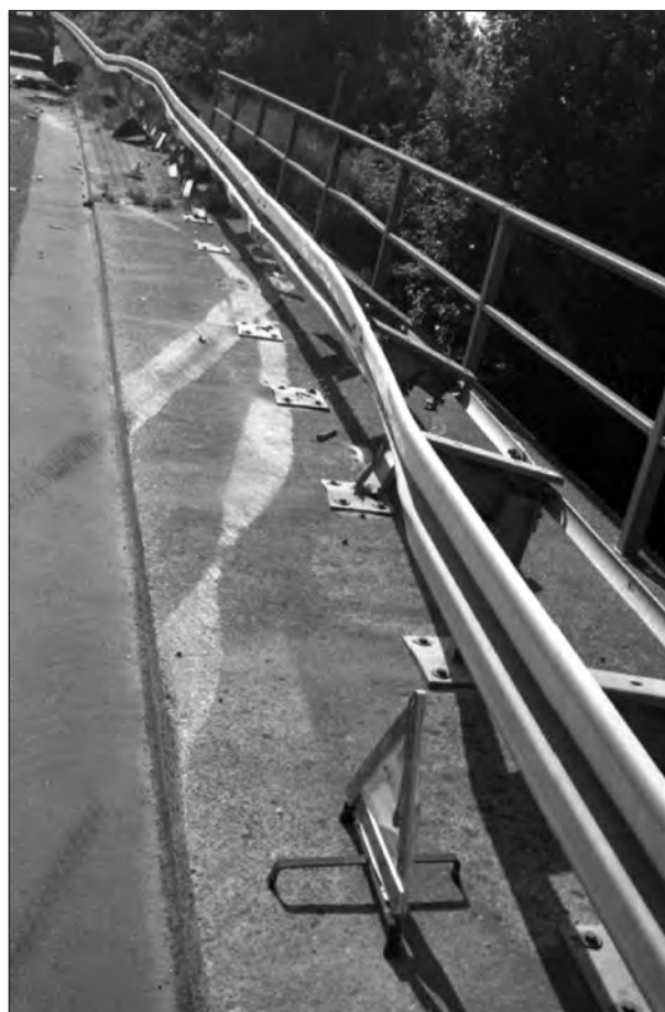
Bild 4: Beschädigungen an der EDSP 1,33 m
