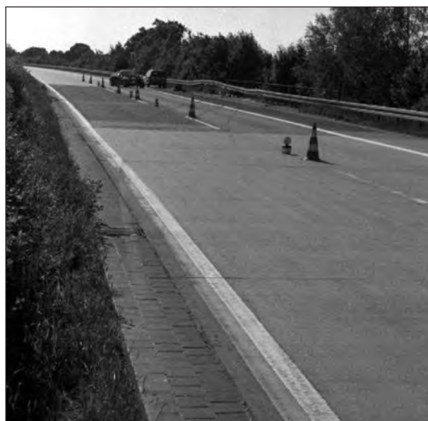
Bild 2: Unfallstelle in Fahrtrichtung mit Schleuderspuren und beschädigter Stahlschutzeinrichtung
