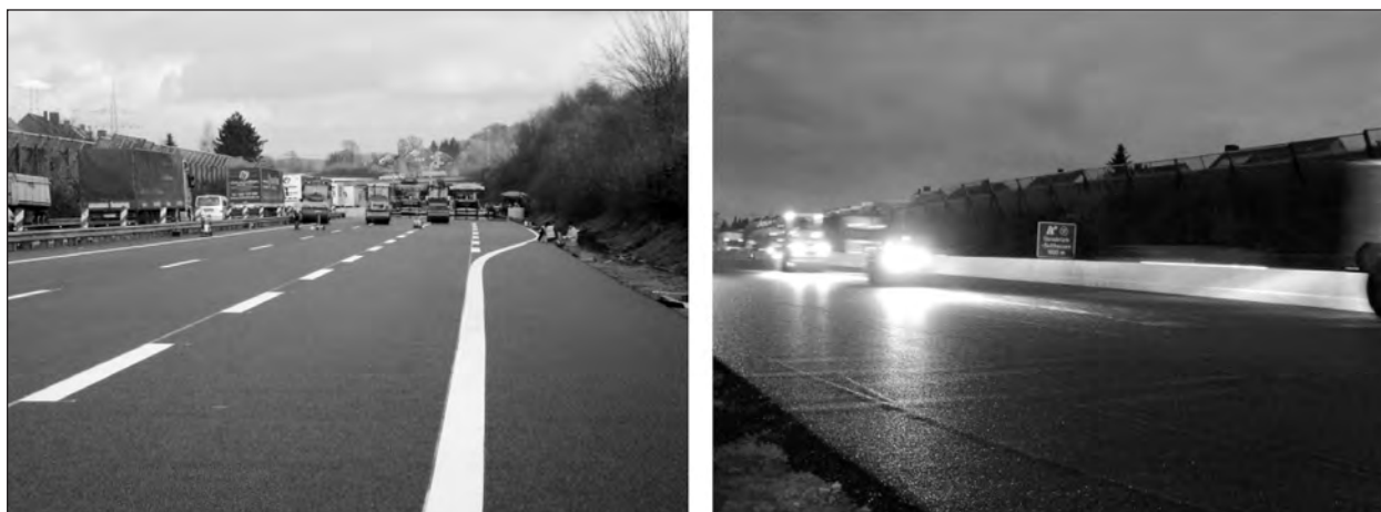
Bild 7: Einbau Bauabschnitt 2007-3 GM. Rechts: Unebenheiten durch Fertigerstillstand
